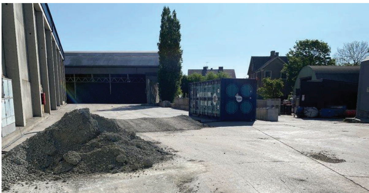
Figur 14, Energilagrets placering. Matarkablar är nergrävda i marken mellan lagret och byggnaden till vänster i bild.
